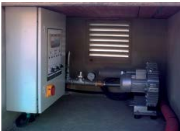
Cuadro eléctrico y compresor
